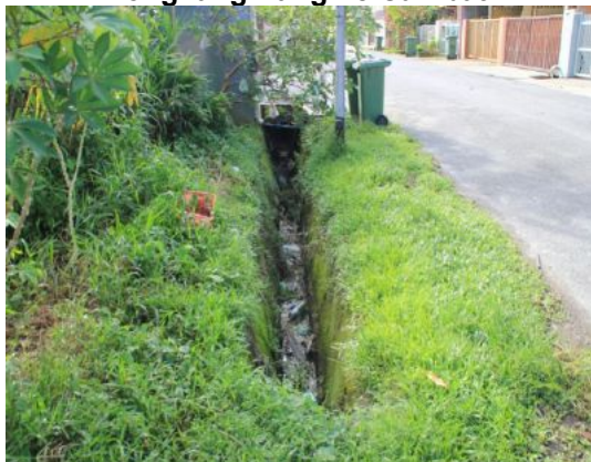
Gambar 1.15 Longkang Yang Tersumbat
