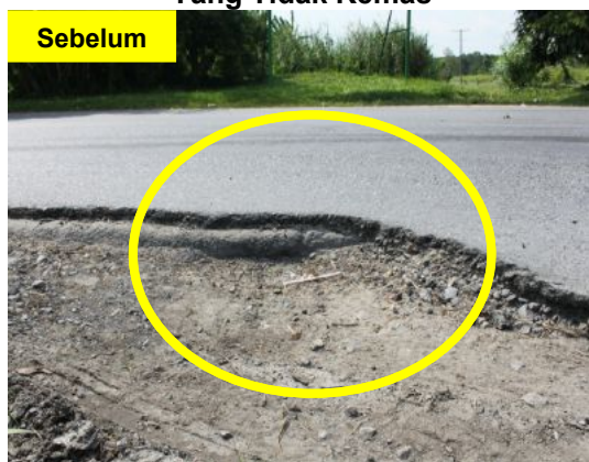
Gambar 4.1 Kerja Penurapan Jalan Yang Tidak Kemas
