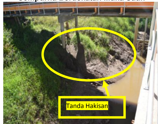
Gambar 3.2 Slope Protection Tidak Sempurna Berdekatan Muka Sauk
