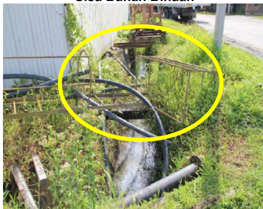
Gambar 1.18 Longkang Tempat Buangan Sisa Bahan Binaan
