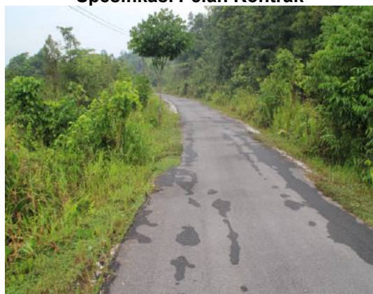
Gambar 1.1 Projek Jalan Kampung Tidak Mengikut Spesifikasi Pelan Kontrak
