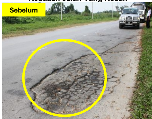
Gambar 4.3 Keadaan Jalan Yang Rosak
