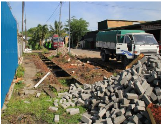
Gambar 1.13 Batu Bata Ditimbun Di Bahu Jalan
