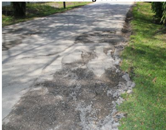
Gambar 1.9 Keadaan Jalan Yang Sudah Rosak
