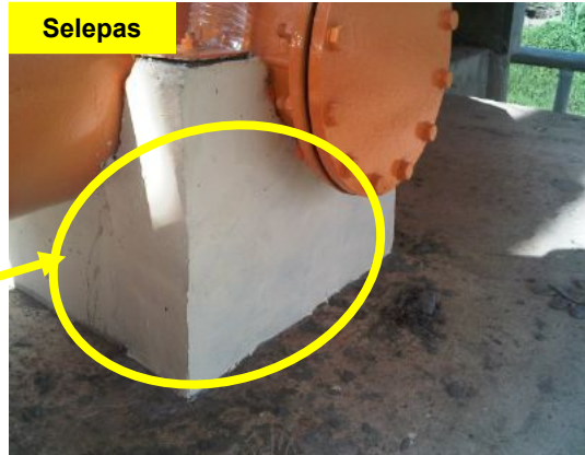
Gambar 3.7 Keretakan Tersebut Telah Dibaiki Dan Di Cat
