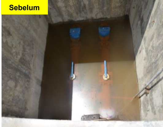
Gambar 3.10 Air Bertakung Dalam RC Chamber Yang Terdapat Injap Kawalan Aliran
