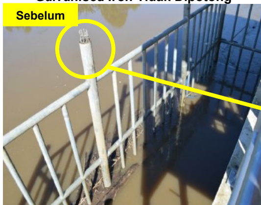
Gambar 3.3 Besi ( Exposed Bar ) Pada Tiang Cerucuk Galvanised Iron Tidak Dipotong
