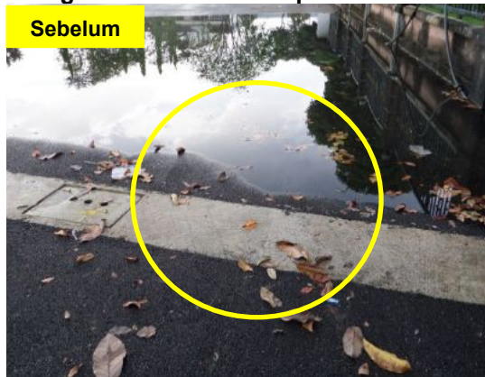
Gambar 4.7 Longkang Baru Yang Tidak Separas Dengan Permukaan Tempat Letak Kereta
