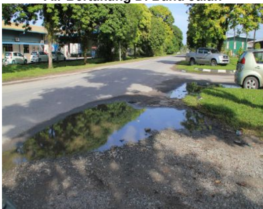
Gambar 1.11 Air Bertakung Di Bahu Jalan
