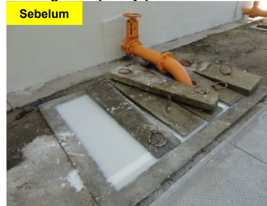
Gambar 3.12 Air Bertakung Dalam RC Chamber Yang Terdapat Injap Kawalan Aliran
