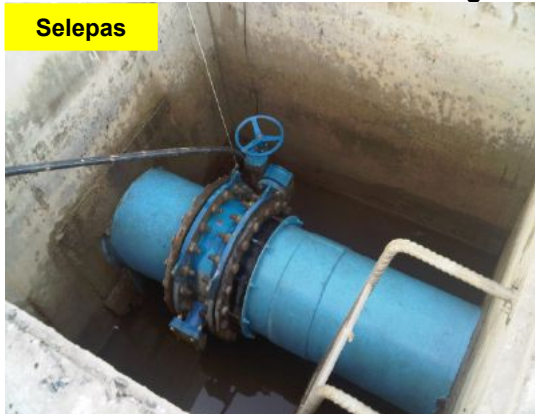
Gambar 3.9 RC Chamber Tersebut Telah Dikeringkan
